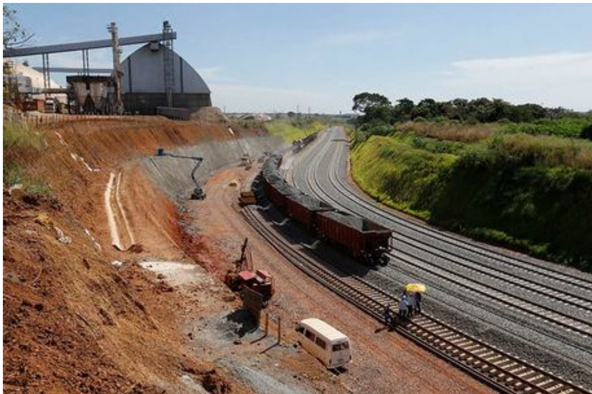
Operários trabalhavam intensamente em Anápolis (GO), uma semana antes da inauguração da ferrovia Norte-Sul, no ano passado. 16.05.2014/DIDA SAMPAIO/Estadão Conteúdo
